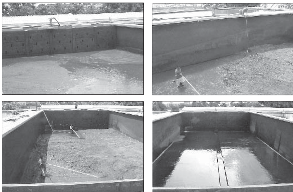
Figura 5.1 Lavagem dos decantadores tradicionais em ETAs.
